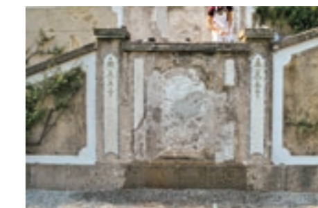
Riadesione dei distacchi nel prospetto superiore e il prospetto inferiore dopo la rimozione della stuccatura in malta cementizia
