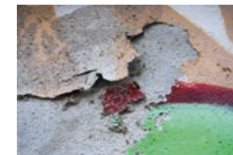
Sollevamenti di intonaco
