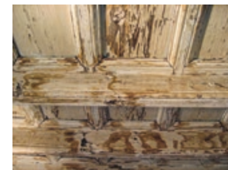
Particolare del soffitto con gore di umidità e spesso strato di scialbo sovrapposto
