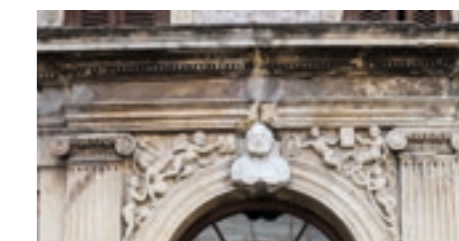
Pennacchi con decorazioni realizzate in alto rilievo, durante le operazioni di pulitura
