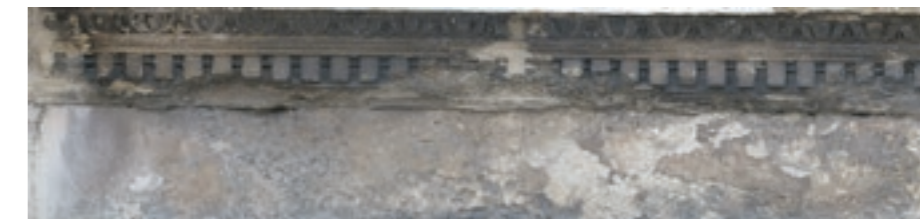
Trabeazione del portale con stratificazioni di crosta nera, distacchi, esfoliazione, erosione, lacune e disgregazioni
