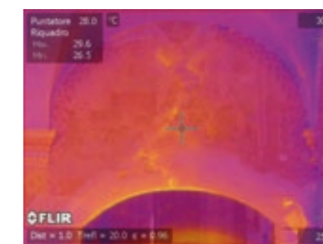
Rilievo termografico lunetta di figura 1
