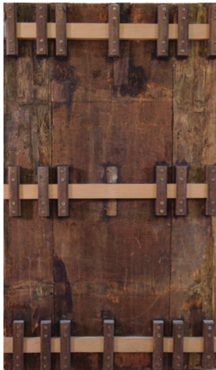
Retro condizioni iniziali
